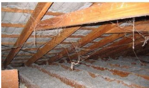
Toplotna azbestna izolacija na podstrešju
