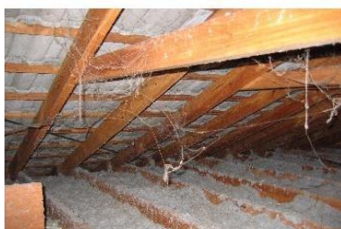
Toplotna azbestna izolacija na podstrešju
