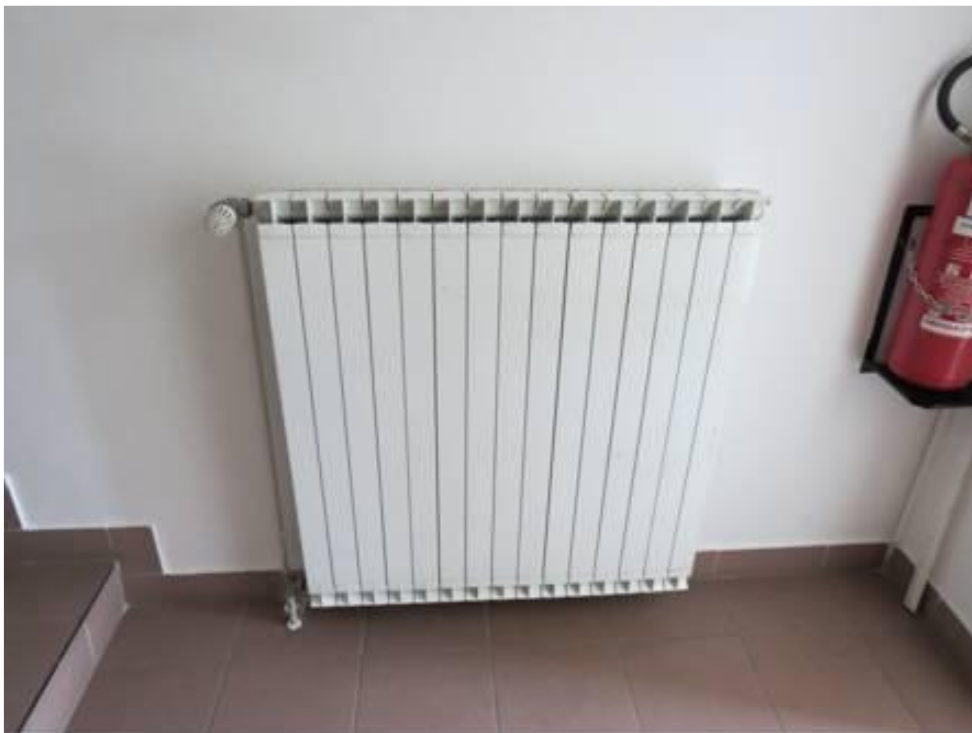
Slika 4.4: Radiator s termostatskim ventilom
