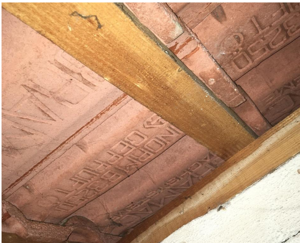
Slika 5.2: Neizolirana streha, ki meji na neogrevan del podstrešja
