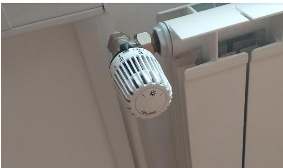
Slika 4.5: Termostatski ventil na radiatorju
