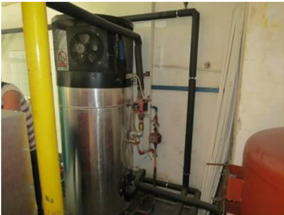
Slika 4.6: Toplotna črpalka za pripravo tople sanitarne vode
