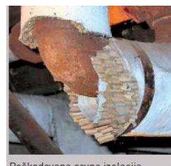
Poškodovana cevna izolacija
